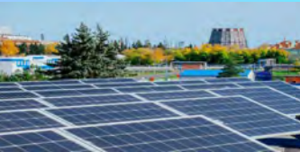
Омский НПЗ (ПАО Газпром нефть). Солнечная станция мощностью 1 МВт размещена на площади 2,5 га и состоит из 2,7 тыс. солнечных панелей. Себестоимость (25 лет) 3 руб/кВт*час.
